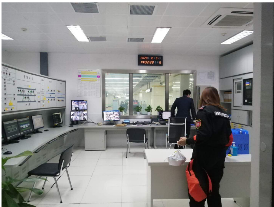
车站控制室现场
